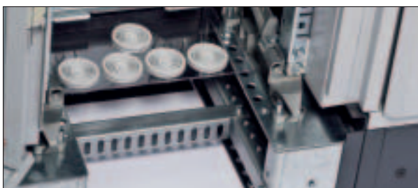
Fixation des câbles
