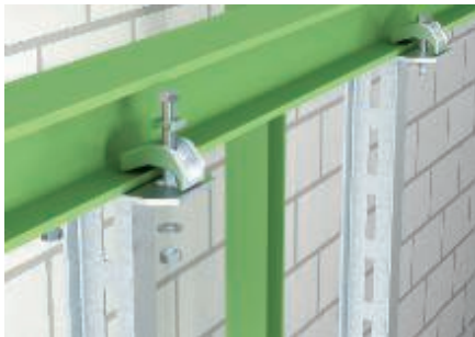
Montage direct d'un pendard en I à l'aide de crapauds lourds type TKS-S-30. Cheminement parallèle à l'IPN.
