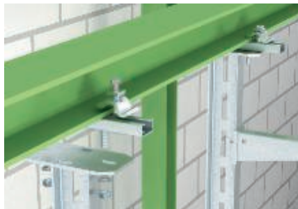
Montage sur IPN des pendants en I avec un rail en C et les crapauds type TKH-L-25. Cheminement parallèle à l'IPN.
