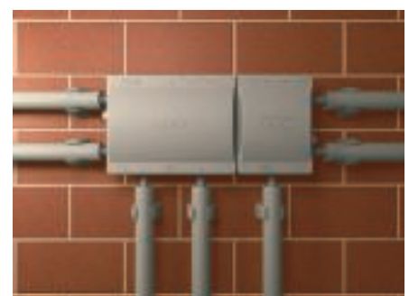
Montage et installation terminés des boîtes de dérivation types ECO12 et ECO18 en série avec des tubes Quick-Pipe et colliers OBO Quick 2955.
