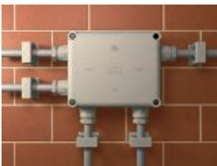
Montage et installation d'une boîte de dérivation type B11 terminés avec presse-étoupes coniques vissés et colliers à pression isolants
